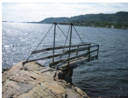
Stupebrett har matte med snublekant. Installasjonen er ikke risikovurdert
